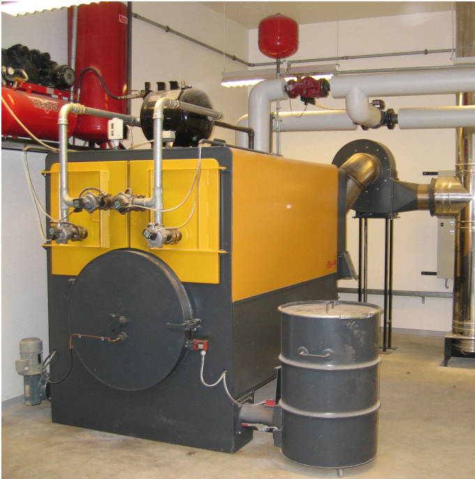
Kedelanlæg med stoker, cellesluse, snegl og tilbagebrandssikring. Askeudtag med 210 L tønde samt sodblæsning for røgrørsrensning.
